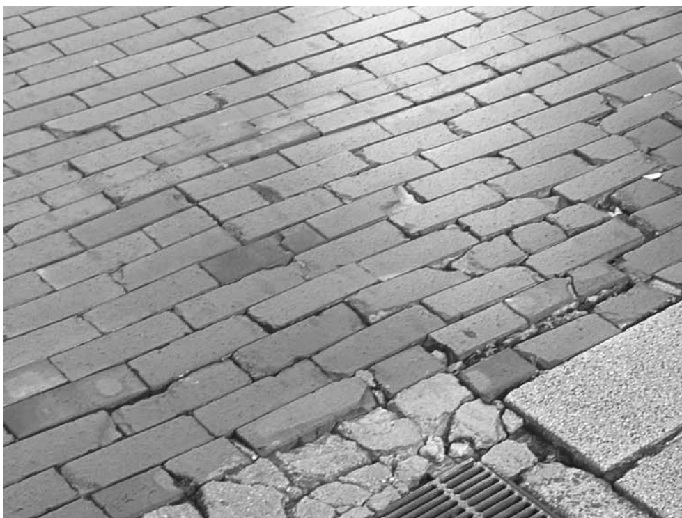
写真-5 レンガ舗装の破損状況
